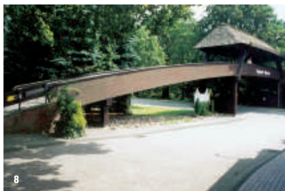
8 Regelmässige Neuanstriche ermöglichen der ungeschützten Fuss- und Radwegbrücke in Walsrode aus dem Jahre 1972 das Erreichen ihrer theoretischen Nutzungsdauer von 40 Jahren
